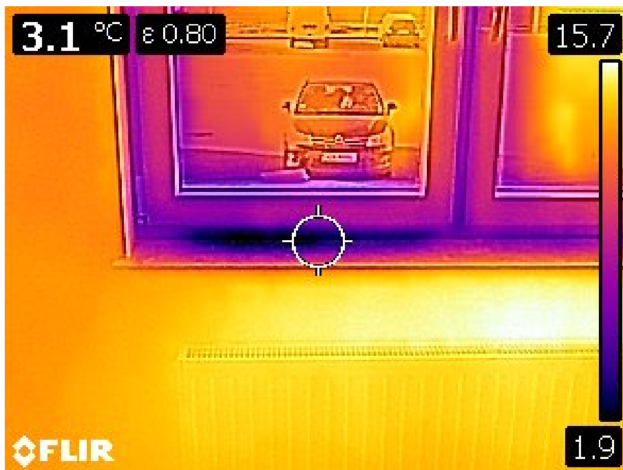
nieprawidłowe obsadzenie okna w pokoju dziecięcym
